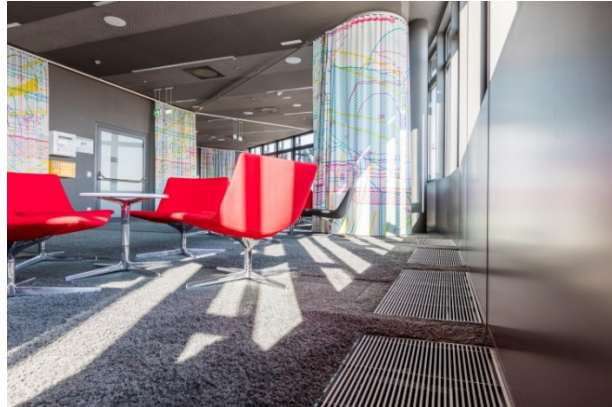
In den Büroräumen entschied man sich für Bodeninduktionsdurchlässe von TROX, mit denen gelüftet, geheizt und gekühlt wird.
