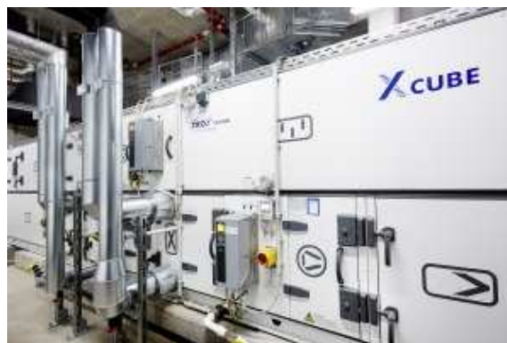
30 X-CUBE RLT-Geräte sorgen mit 450.000 m 3 /h Volumenstrom für Frischluft im Gebäude
